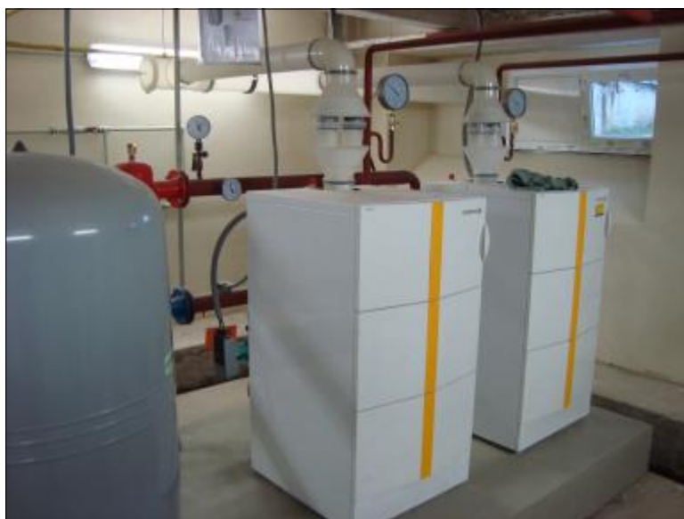
Kotelna ZŠ před a po rekonstrukci
